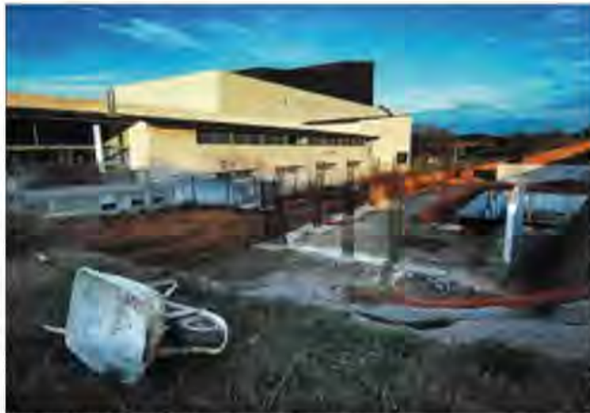
Obras paradas de la escuela de música de Sant Cugat del Vallès. / JORDI MOTA
