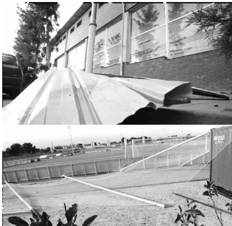
Un tros de sostre del pavelló del Serrallo de Tarragona i l'interior amb les darreres del camp de futbol de Cambrils.
